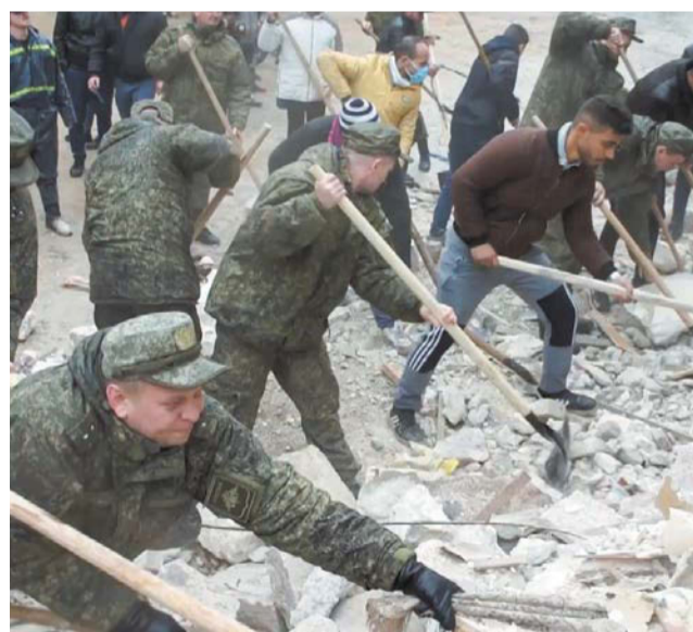
Российские военные помогают с разбором завалов здания, разрушенного в результате землетрясения в сирийском Алеппо | ПРЕСС-СЛУЖБА МИНОБОРОНЫ РФ | ТАСС
