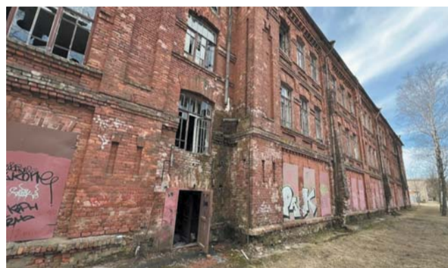
Здание признали аварийным
