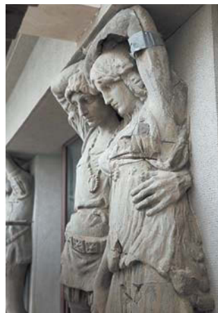
Были выявлены повреждения скульптурных композиций
